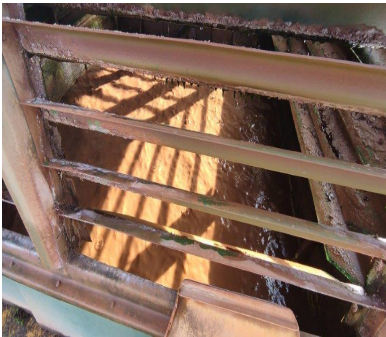
Foto 6 - Torres Resfriamento 1 ano após instalação do sistema (presença de aragonita)
